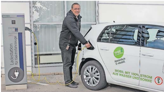
Eine neue Ladesäule steht bei den Stadtwerken in der Ansbacher Straße.
