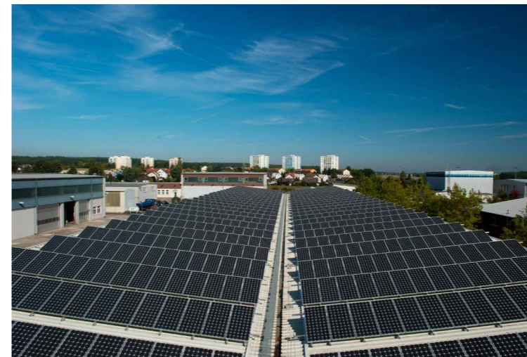
PV-Anlage der Stadtwerke
