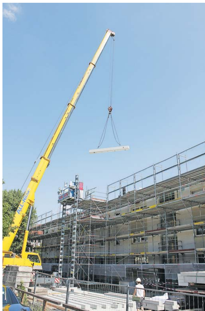
Beton am Haken: Per Kran werden die Fertigteile auf das Dach gehoben.
