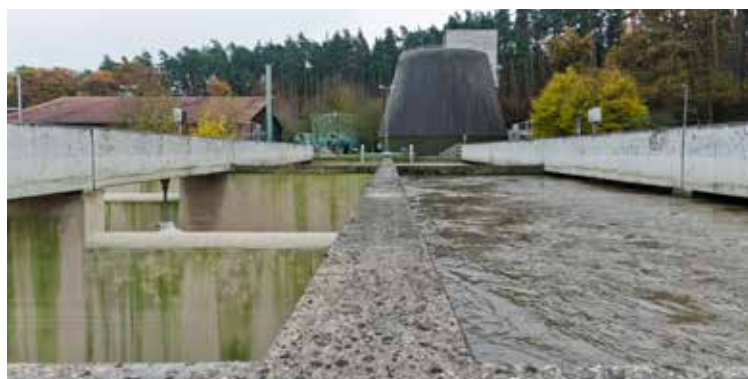
Blick in die Kläranlage: vorne das Belebungsbecken, dahinter der Faulbehälter
