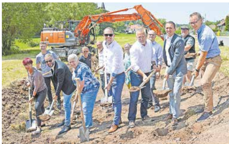
Spatenstich für ein lange währendes Projekt: Oberbürgermeister Peter Reiß (Mitte) griff zusammen mit Marie Kroiss (Planungsbüro Siegle), Jörg Maier (Tiefbauamt), Hasan Ezzo (Baufirma Fiegl), Petra Haußmann (IG Dietersdorf), Karl-Heinz Kühn und Michael Napokoj (Fiegl), Pfarrerin Renate Schindlbauer, Stadtbaurat Ricus Kerckhoff, Lars Kullick (Stadtplanungsamt), Dr. Maximilian Hartl (Referent für Mobilität), Heinz Mathis (Planungsbüro Paul) und Stephan Beron (Tiefbauamt) zum Spaten.
