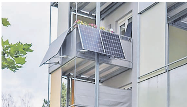
So sieht eine Balkon-PV-Anlage aus.
