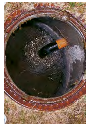
Abb.: Schacht aus Beton
